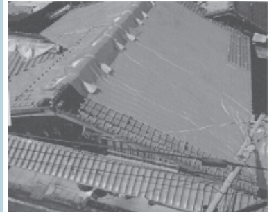
▲ 台風飛ばされた屋根
