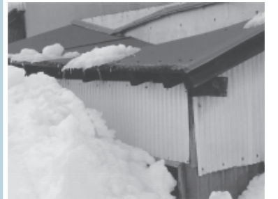
▲ 雪の重みでつぶれた屋根
