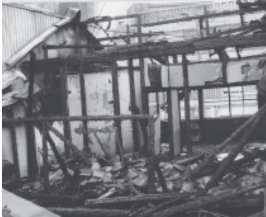
▲ 火災により焼けた建物
